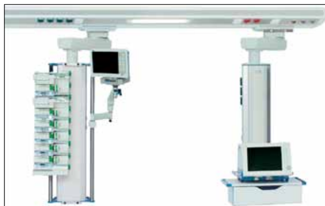
Rycina 1. System sufitowych belek zasilających Ponta® (Dräger) zainstalowany w jednoosobowych salach Oddziału Intensywnego Nadzoru Pooperacyjnego CMI
