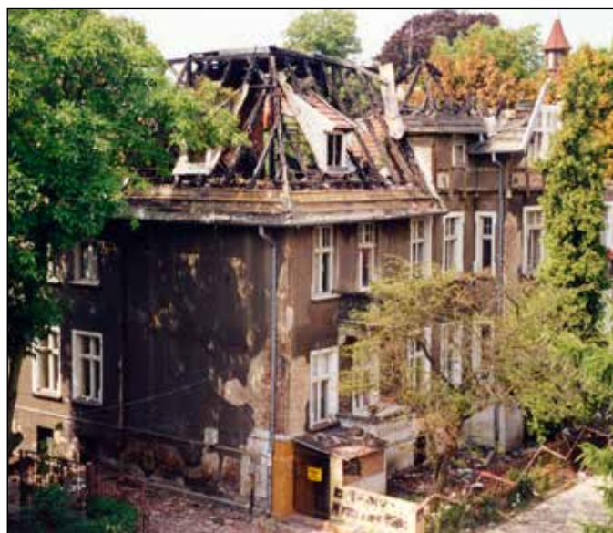
Kamienica nr 5 na ul. Małachowskiego po pożarze
